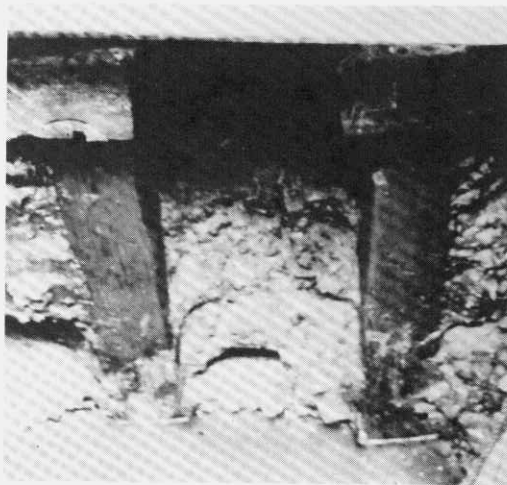
Fig. 2. Blottet pælefundering fra Det Gule Pakhus. Det ses, at det er ubeskadiget.
